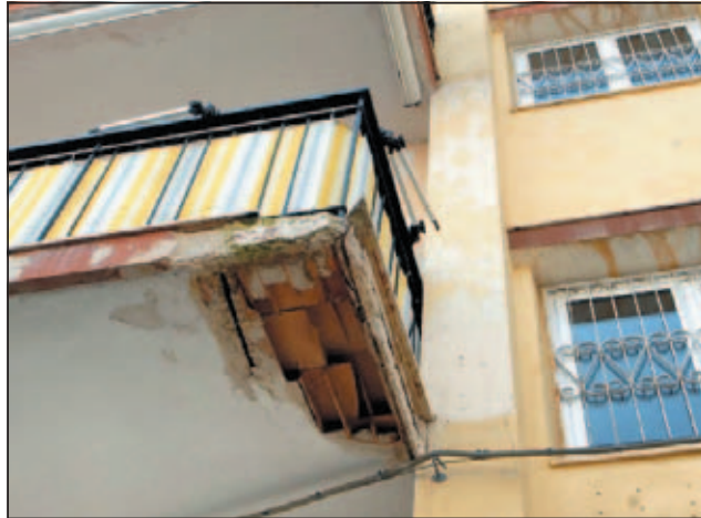
Balconi nel degrado alle palazzine lacp di via Baresano da Trani al quartiere San Paolo di Bari. Sotto a sinistra, Vincenzo Zotti, uno dei residenti, mostra una delle pietre staccatesi dal palazzo che ha, tra l'altro, danneggiato la sua nuova auto
